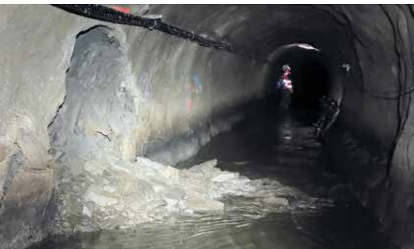
Dégradation de la galerie de rejet au Rhône
