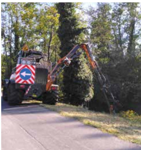
Fauche de la digue de la Leyse
